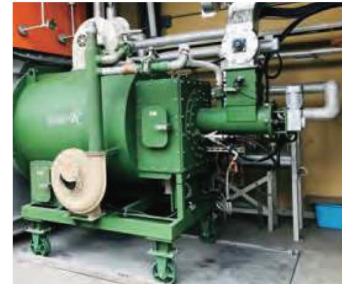
事例紹介：廃プラボイラ導入について
